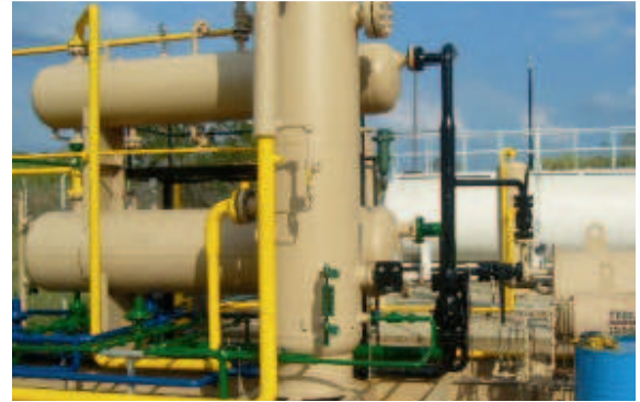
ESTACIÓN DE GAS
