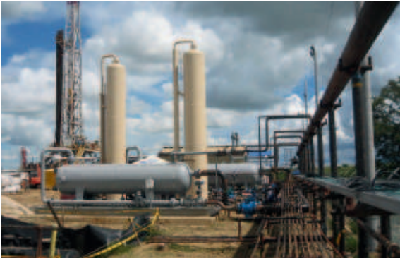
ESTACIÓN DE GAS
