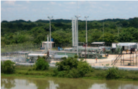
ESTACIÓN DE GAS
