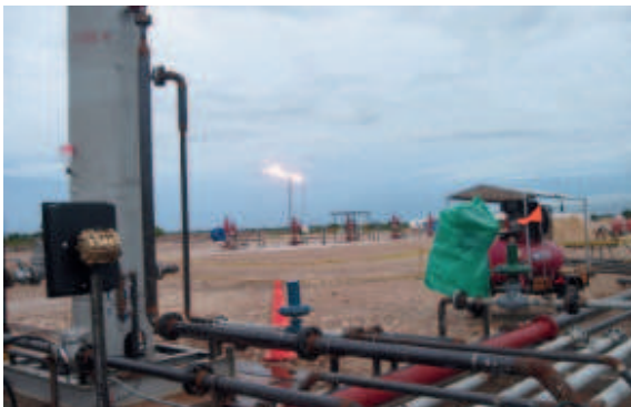
ESTACIÓN DE GAS
